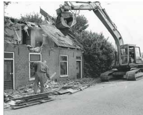
Sloop van huis op Visschersbuurt ten behoeve van de dijkverzwaring. Bron: De Dordtenaar.
